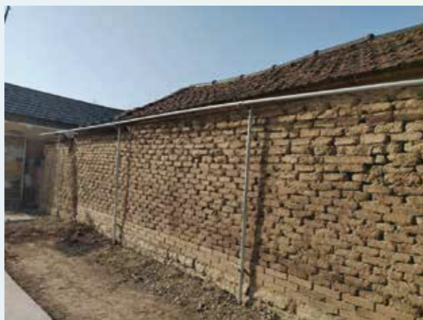
▲ 图 21辛兴东南村天然气管道
